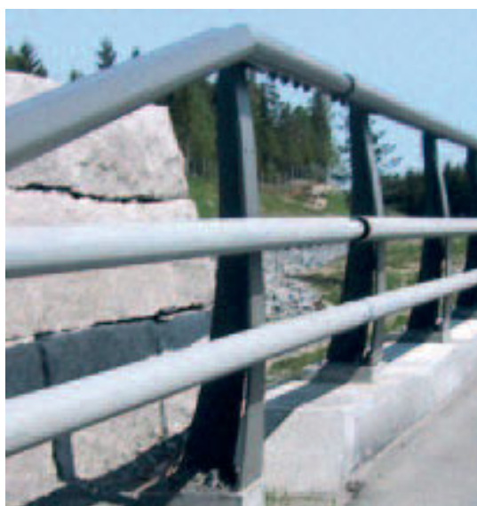
Rekkverk med skarpe kanter og uheldig avsluttet føringskant.
